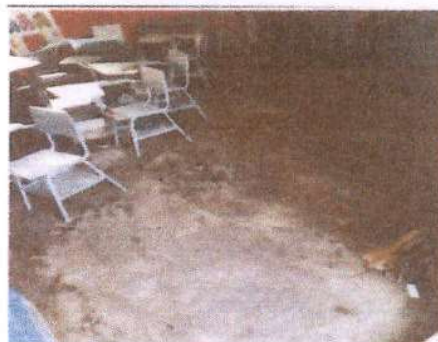
Foto. 2 Mal estado en piso en aula número 2 Módulo 2
