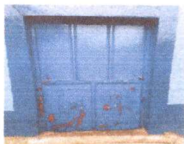
Fot 5. Puerta de aula número 1, oxidada, torcida, en mal estado Módulo 2, necesario cambiarla, medida 2.10 10*1mt.
